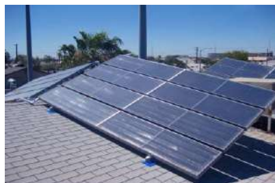
Fig. 5 Solar Thermal Collectors
